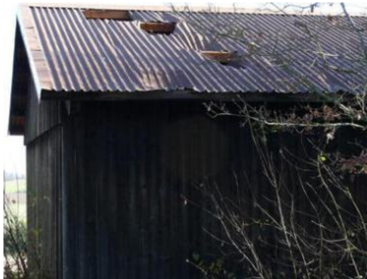
Eisgeschosse von einem 130 Meter entfernten Windrad haben ein Scheunendach bei Ehingen durchschlagen. Zum Glück haben sie kein Schädeldach getroffen
